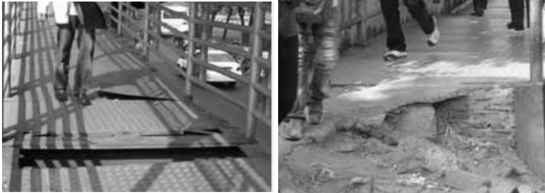
Gambar 12. JPO Benhil yang Lantainya Jebol dan Rusak.
